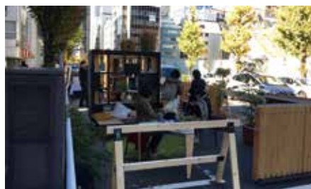
写真1：道路を1車線塞いで休憩施設を整備した。休憩施設全体を車道に置いた全国初の事例である。
